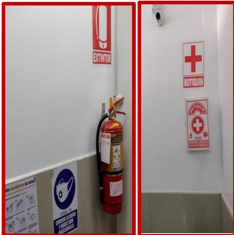
Foto N° 08. Extintor y botiquín
